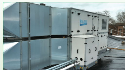
Ecovent RO opstelling met een luchtverplaatsing van 14.000 m 3 /h, gerealiseerd in Arnhem
