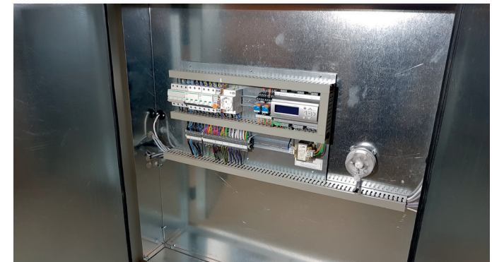
Ruime technische sectie makkelijk toegankelijk
